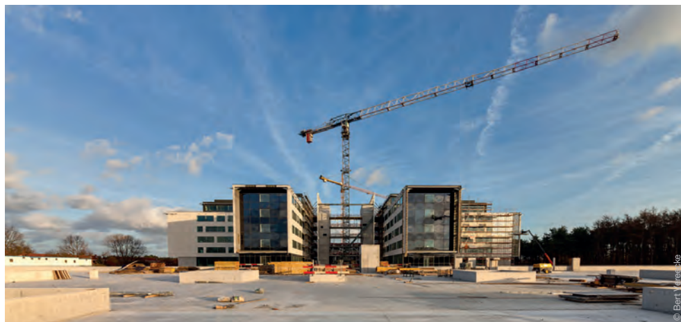
Bij de nieuw bouw van AZ Alma Eeklo hospitaal is een groot atrium het bijzondere aandachtspunt voor de brandbeveiliging.
